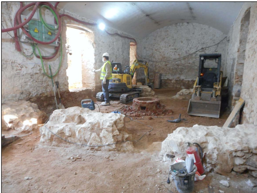
30. Àmbit B, final de les tasques de rebaix. En primer terme UE105.
