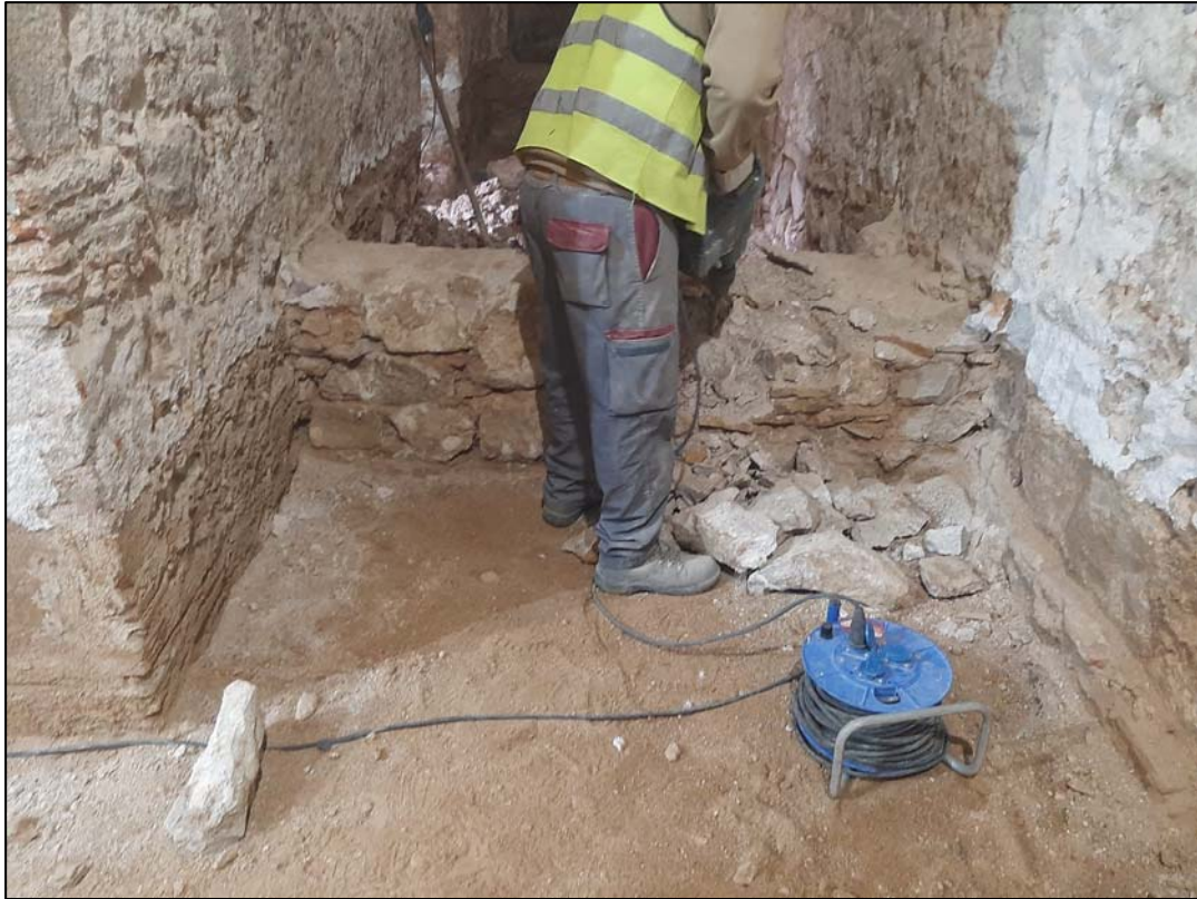
75. Treballs d'enderroc dels primers 60cm de les estructures documentades. Àmbit A UE 105-106.
