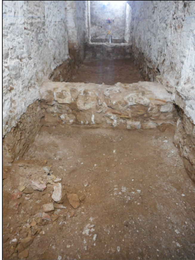
39. Àmbit A, final de les tasques de rebaix. En primer terme UE105, al fons UE106.
