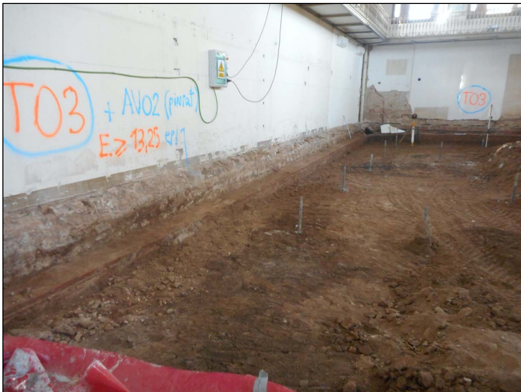
8. Estat final de les actuacions de rebaix de l'ala nord de la planta baixa.
