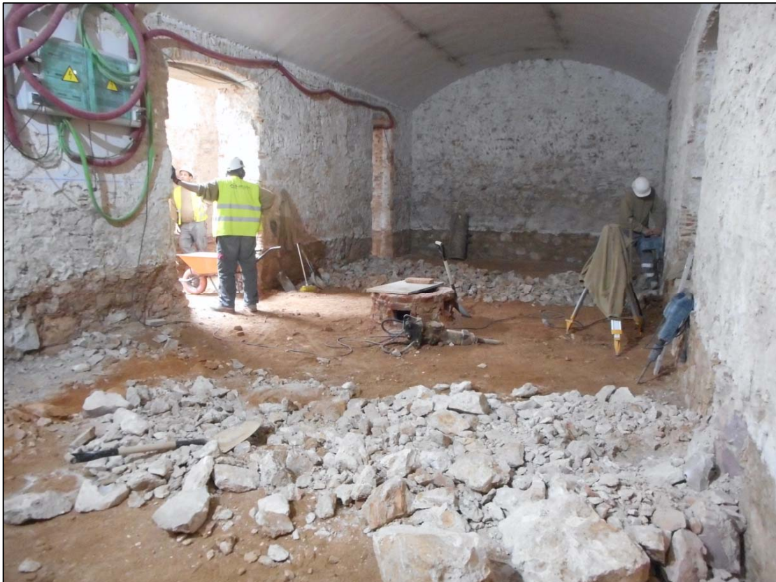
68. Treballs d'enderroc dels primers 60cm de les estructures documentades. Àmbit B UE105-106.
