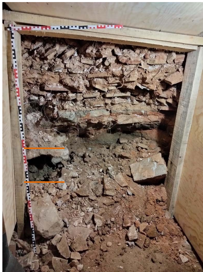
118. Inici d'excavació de la Mina 2 des del Pou 2. S'observa la zona per on discorre la UE 10.
