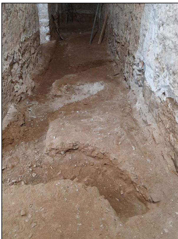
62. Àmbit A. Tasques de realització de les rases per al nou sistema de sanejament.
