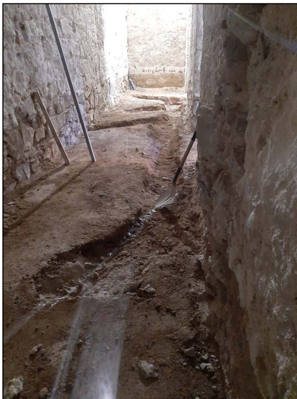
63. Àmbit A. Tasques de realització de les rases per al nou sistema de sanejament.
